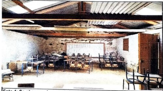
Foto 4: Se observa claramente la necesidad de sustituir la estructura de madera en mal estado. Modulo 2
