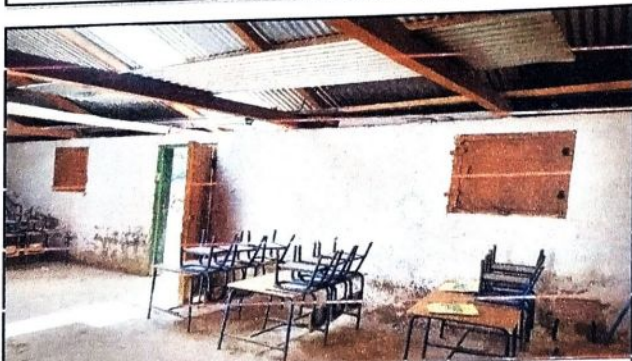
Foto 10: Se observa claramente la necesidad de sustituir las ventanas. Modulo 2
