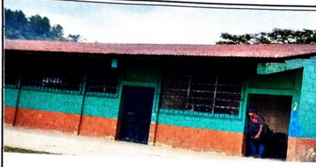
Foto 1: Vista frontal de establecimiento, donde se refleja el mal estado en que se encuentra el entechado del mismo (laminas y capotes). Modulo 1
