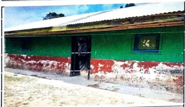
Foto 9: Se ve la necesidad de sustitucion de puerta en mal estado. Modulo 2
