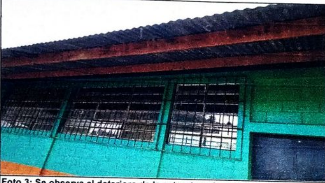
Foto 3: Se observa el deterioro de la estructura de metal. Modulo 1
