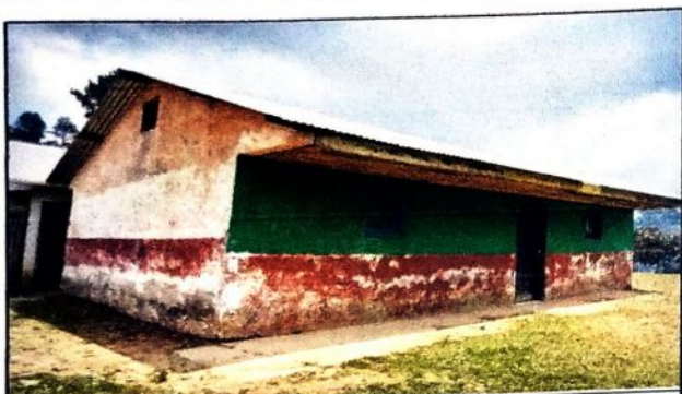
Foto 7: Vista panorámica de la necesidad de aplicación de pintura en paredes interiores y exteriores. Modulo 2.
