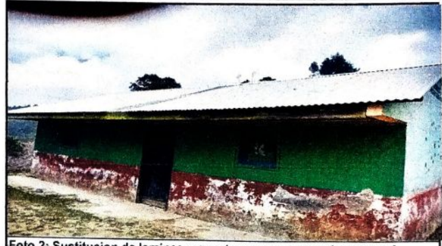
Foto 2: Sustitucion de laminas y capotes que se encuentran en mal estado, modulo 2.
